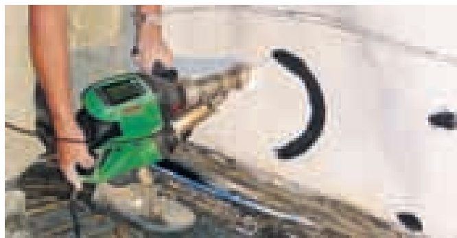
Удобный и надежный ручной сварочный экструдер WELDPLAST S2 при работе в туннелях.
